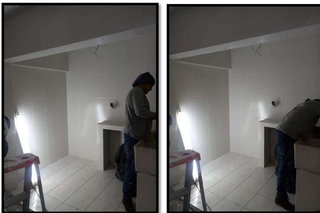
Figura 29-. Remodelación del lugar de trabajo de la producción.
